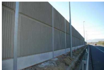
15. irudia: Hormigoizko pantaila akustikoa
